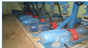
Filtración en PEAS por rotura en ducto producto de mala manipulación de retroexcavadora – Trabajos Densificación, Densificación
